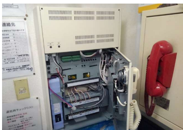
新品非常警報灯取付
