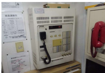
既存非常警報盤
