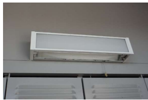
階段灯 既存照明 ↓
