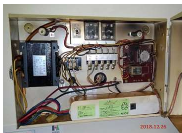
電源装置内部
