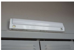
階段灯 新品LED照明 点灯試験済
