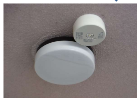
階段灯 新品LED照明 新品非常灯LED
